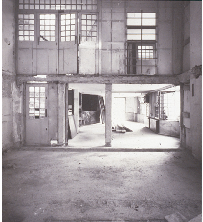
Abb. 17: Die originale Trennwand zwischen Kundenbereich und Werkstätten fand sich zwischen zwei späteren Trennwänden aus Beton
