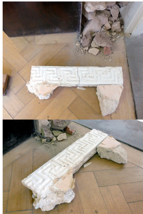
Abb. 6: Abnahme eines Sperrholzpfilers im Speise/Arbeitszimmer: Blendpfiler durch das Gewicht der Füllung aus Ziegeln und Bauschutt stabilisiert, darin Fund eines Mäanderfriesfragments aus Stuck, Putzreste mit blassrosa Tapete – vermutlich Dekorelement der vor Einbau der Sperrholzpfiler abgebrochenen Gipspfiler
