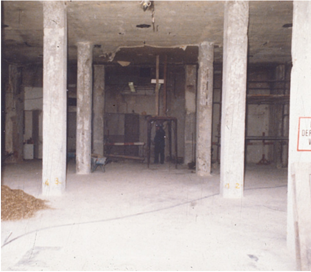
Abb. 14: Zustand zu Beginn der Wiederherstellung im Erdgeschoß 1989
