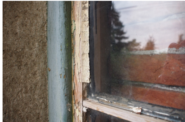
Abb. 12b: Detail eines Originalfensters der Nordfassade (Eingangsfassade) mit nachträglicher Vermauerung anliegend an einen glatt verputzten Innenrahmen, innen ist das zugemauerte Fenster unter einer Wandtäfelung verborgen, Aufnahme 2021, Museum der Stadt Brünn
