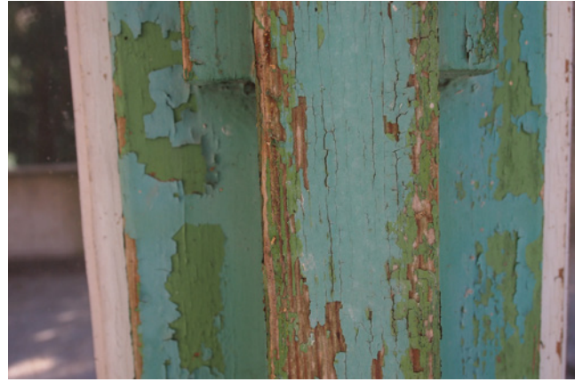
Abb. 12a: Grüne Fragmente von Anstrichschichten auf einem Originalfenster der Westfassade (Gartenfassade), Aufnahme 2021, Museum der Stadt Brünn
