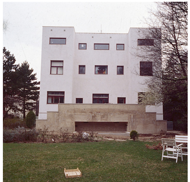
Abb. 2: Haus Steiner, Gartenfassade nach der Rekonstruktion der Terrasse und dem Rückbau der gesamten Fassade
