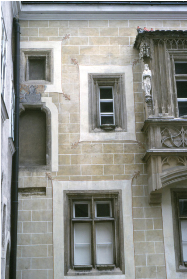
Abb. 14: Klosterneuburg, Altstift (alte Prälatur): Putzquaderung mit weißem, vorgeritztem Fugennetz und aufgeputzten weißen Fensterrahmen mit Putzschnittlilien nach Restaurierung 1981
