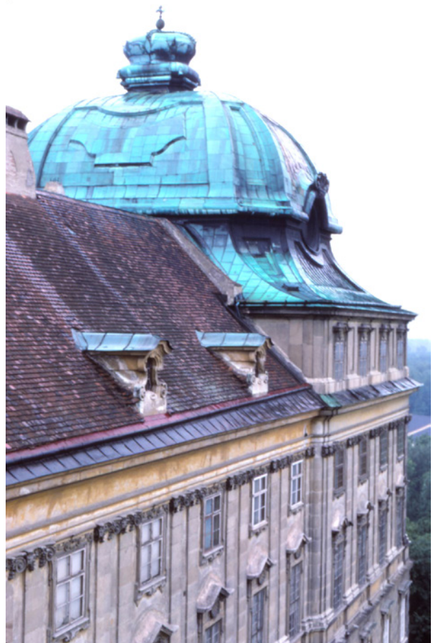
Abb. 16: Klosterneuburg, Stift, Kaisertrakt, Ostfassade mit nordseitigem Eckkrisalit: Gliederung mit unverputzten Steinquadern, verputzt gezogenes Dachgesims
