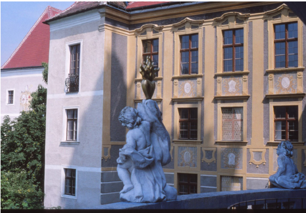
Abb. 4: Dürnstein, Altstift: Weißes Putzgraffito einer Eckquaderung (16./17. Jahrhundert) in der Sockelzone der an den neuen Prälaturtrakt grenzenden Eckkache
