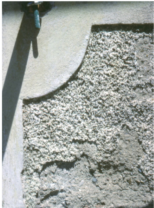
Abb. 12: St. André an der Traisen, Nischengebiet: glatter (ursprünglich blaugrau gefasster) Putzrahmen und dunkelgrau eingefärbter Strukturputz der Vertiefung
