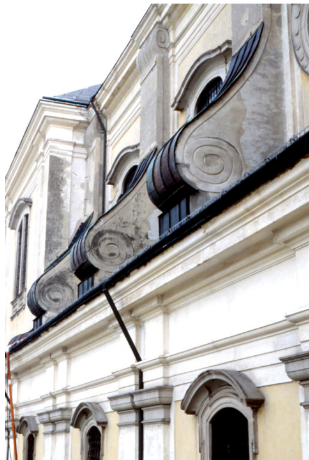
Abb. 19: St. Florian, Stiftskirche, Langhaus, Nordfassade, Untersuchung 1993: originale Graufassung von Pilastern, Voluten und Fensterrahmen am Obergaden ebenso wie bei Pilastern und Fenstern der unteren Langhausfront (bei der Neufassung wurden nur die Fensterrahmen grau gefasst, Pilaster und Voluten aber wie die Gesimse weiß gelassen)
