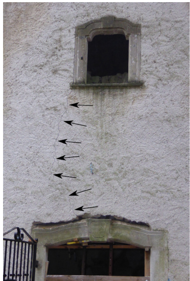
Abb. 10: Westfassade mit statischem Mauerriss
