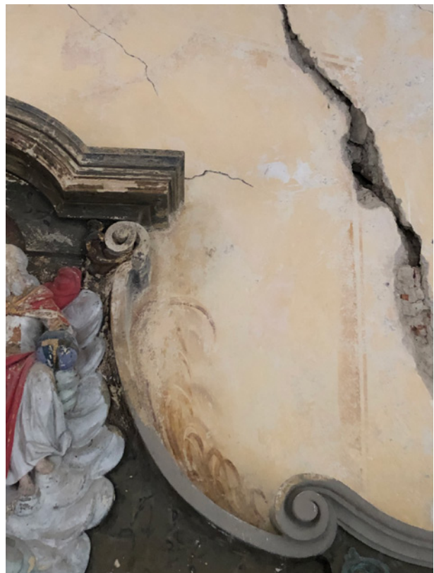
Abb. 12: Altarraum, Apsiswand vor Restaurierung mit alten Mauerrissen
