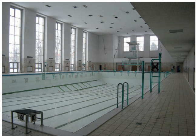
Abb. 7: Schwimmhalle Finckensteinallee Berlin Lichterfelde vor der Sanierung, 2009
