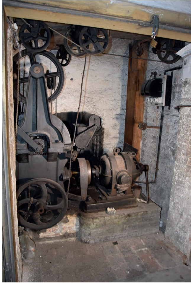
Abb. 3: Mercedeshof, Baden, Keller, elektrischer Motor für den Aufzug
