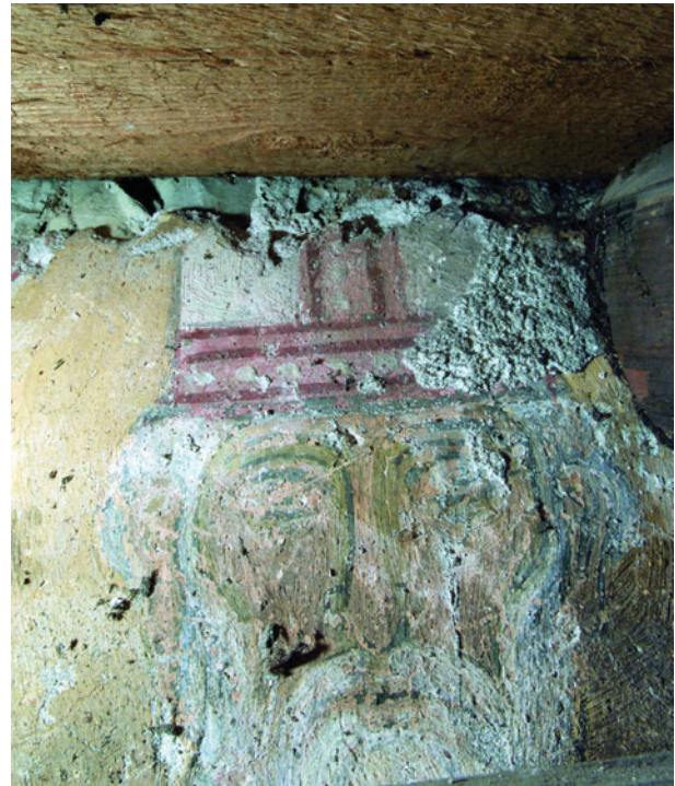
36. Manchmal muss man zu unorthodoxen Methoden greifen: nachdem die romanische Malerei des 12. Jhs. hinter einer wenige Zentimeter vor der gemauerten Architektur liegenden Pfette festgestellt war, stellte sich die Frage ihrer Erfassung und Dokumentation. Dazu wurde durch den Fotografen Stefan Oláh, Wien, ein Flachbettscanner auseinandergelassen und die blanke Scan-Einheit hinter die Holzkonstruktion eingeführt. Nur so war eine bildliche Erfassung möglich, wobei die Tiefenschärfe ein gewisses Problem blieb.
