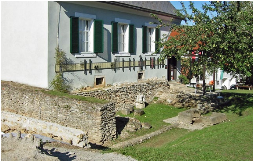
Der Zustand der Ruine vor der aktuellen Sanierung
