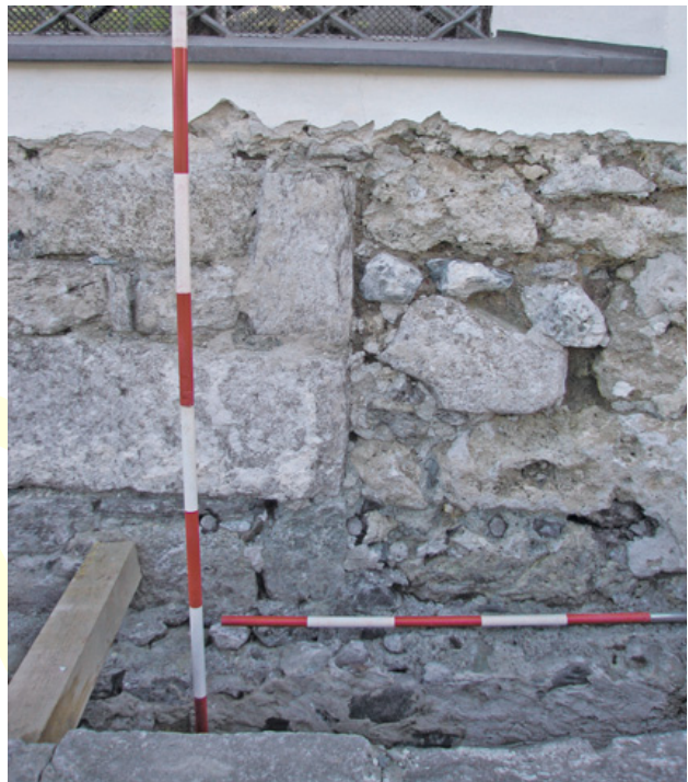
Abb. 86: Felben. Filialkirche Hl. Nikolaus. Baufuge zwischen romanischem Langhaus und spätgotischer Westerweiterung.
