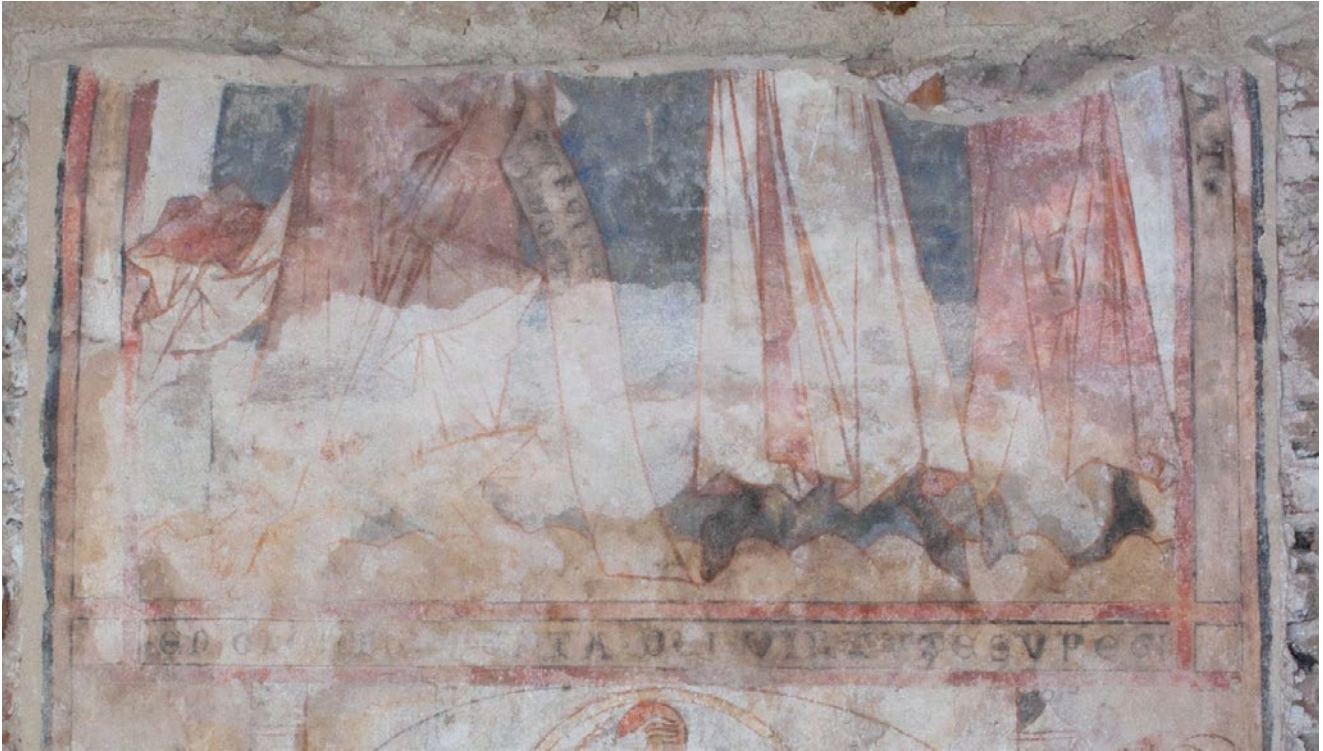
Abb. 9: Manches der späteren Umnutzungen hat sich irreversibel in die Epidermis der Raumschale eingeschrieben, etwa eine durch Feuchteintrag und spätere Ausmalungen der Wohnräume reduzierte Bildpartie
